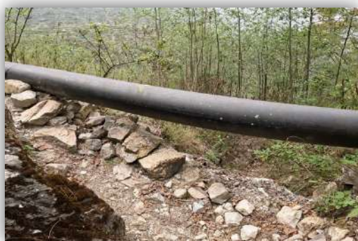
Éboulement sous la conduite d'eau
