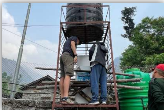
Réservoir d'eau filtrée
